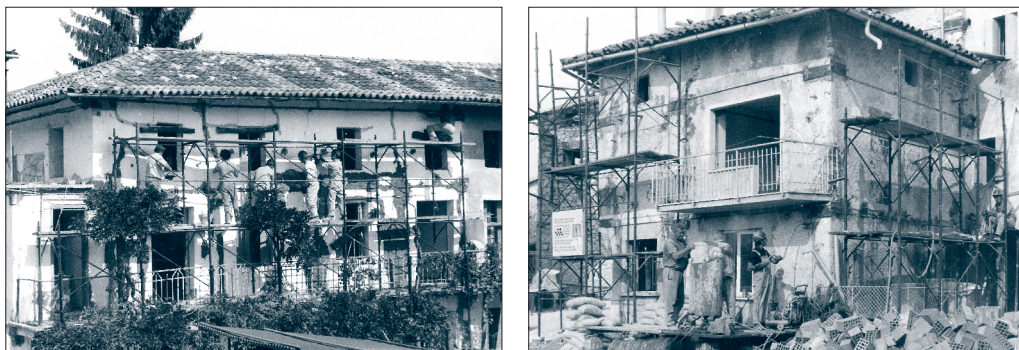
6. a. in b. Utrditvena dela na hišah v zamejstvu. a. polaganje zidnih vezi, b. injektiranje kamnitega zidovja (foto: Edo Vugrinec)
